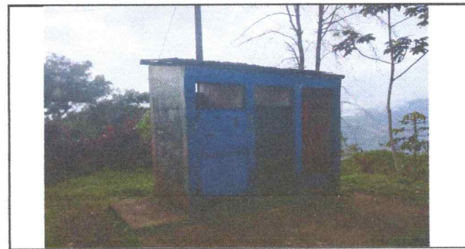
Foto 6: Se observa al modulo de letrina en mal estado
